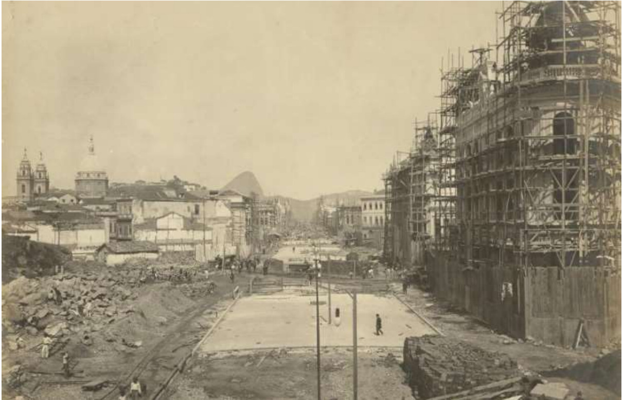
Augusto Malta. Avenida Central - vista panorâmica durante os trabalhos de pavimentação, setembro de 1905 / Museu da República
